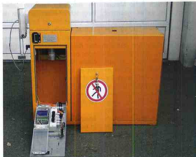
In der Schrankenanlage (orange) befindet sich die Steuerung. Diese ist in das Gehäuse von Bopla (weiß) eingepasst
